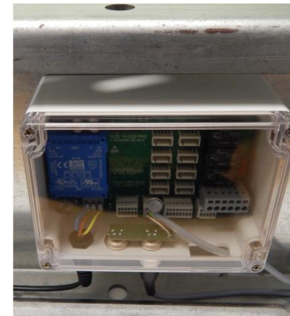
Vertikale Montage, hier gut geschützt durch die Schenkel des Jochs
